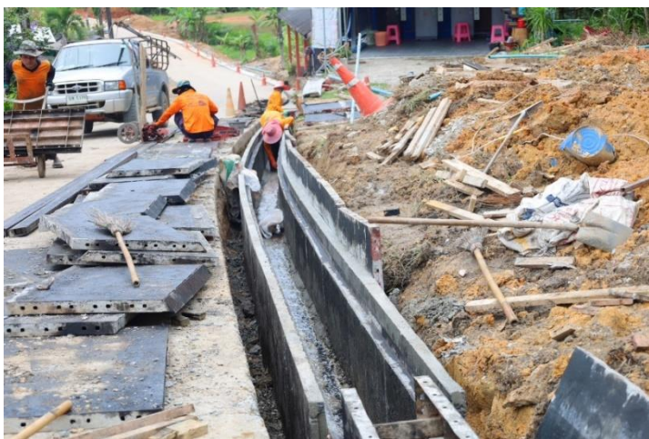
๓๒. โครงการก่อสร้างคูระบายน้ำ คสล. สายหลักคลองเจริญ หมู่ที่ ๒
