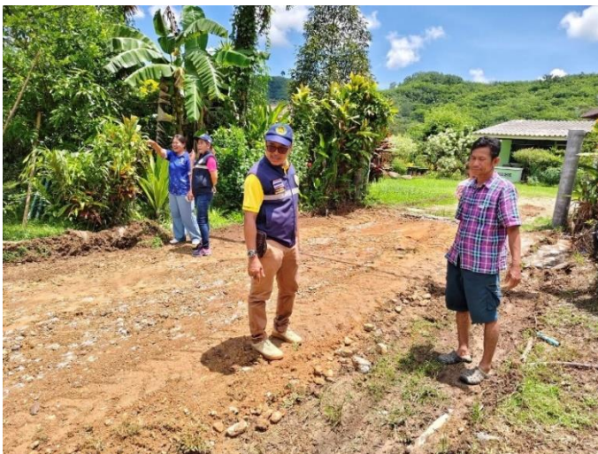
๒๖.โครงการก่อสร้างถนนคอนกรีตเสริมเหล็ก สายบ้านตาพิมพ์ หมู่ที่ ๘
